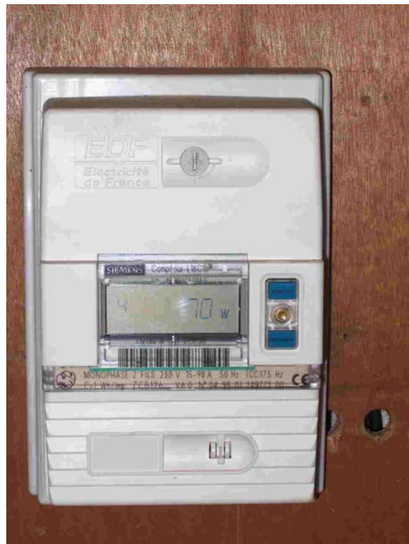
Compteur électronique actuellement installé, montrant la consommation des appareils en veille
